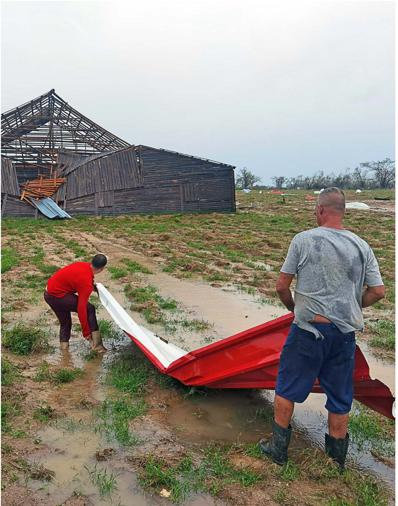
Varios hombres trabajan en la restauración de un almacén de tabaco destruido tras el paso del huracán Ian por Pinar del Río, Cuba (septiembre de 2022). Foto: Yander Zamora
