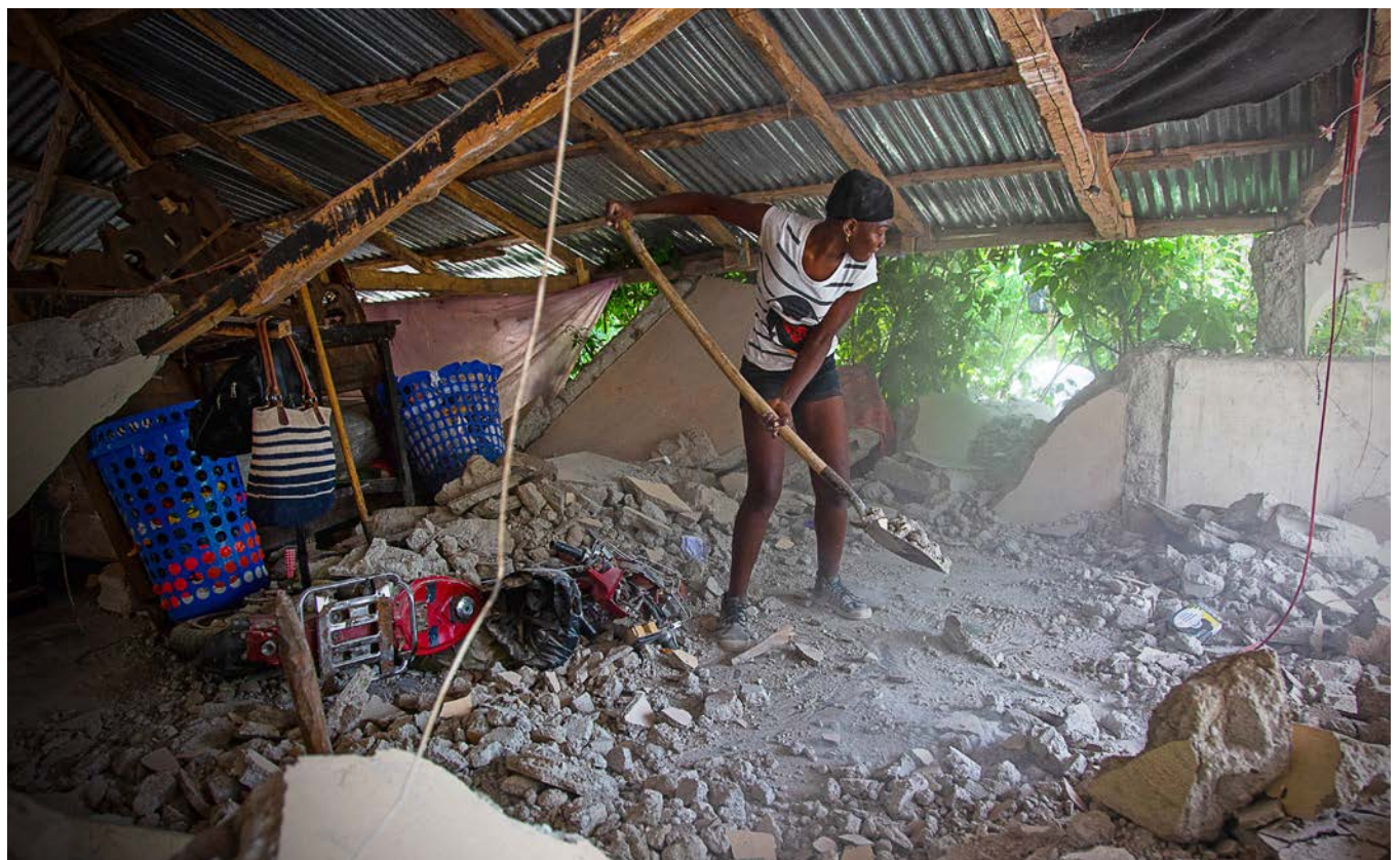
Una residente limpia una casa afectada durante el terremoto en la zona de Capicot, en Camp-Perrin, en el Departamento Sur de Haití (agosto de 2021) Foto: UNICEF
